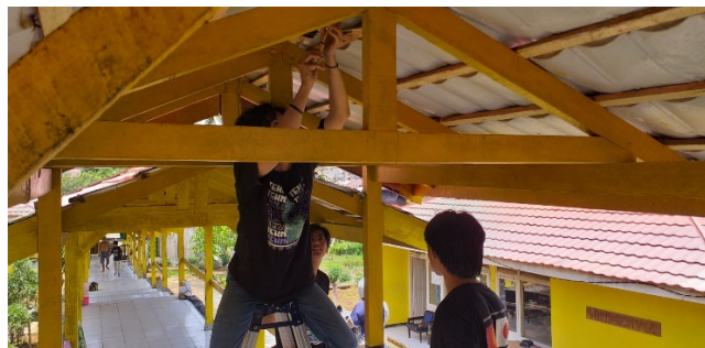
Gambar 6. Instalasi beban lampu DC
