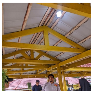
Gambar 7. Sistem instalasi penerangan menggunakan panel surya yang telah terpasang
