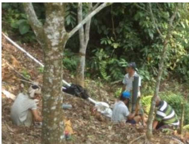
Gambar 6. Lokasi penempatan pompa hidram
