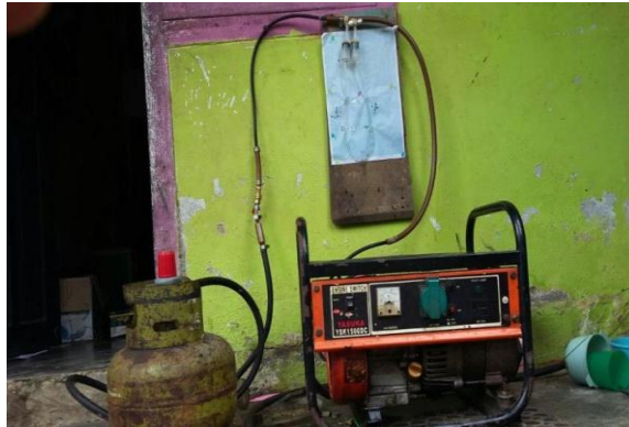
Gambar 2. Instalasi modifikasi genset berbahan bakar gas LPG
