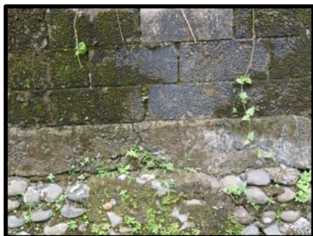
Gambar 15. Keretakan Pada Salah Satu Bagian Sloof Dinding Penahan Tanah
