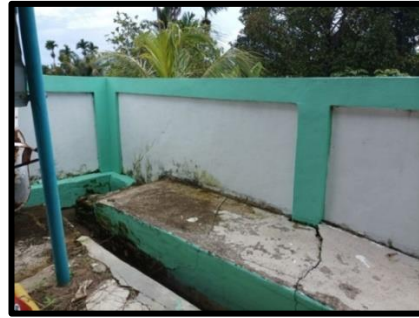
Gambar 16. Kerusakan Pagar Bagian Atas
