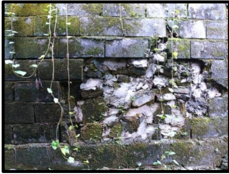
Gambar 13. Kerusakan Dinding Penahan Tanah
