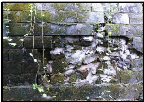
Gambar 14. Kerusakan Dinding Penahan Tanah
