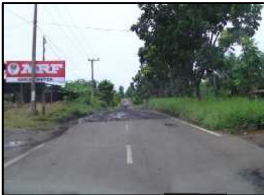
Gambar 4. Jalan Kondisi Rusak Ringan
