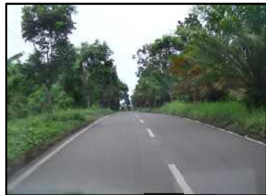
Gambar 2. Jalan Kondisi Baik
