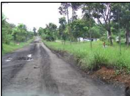
Gambar 5. Jalan Kondisi Rusak Berat
