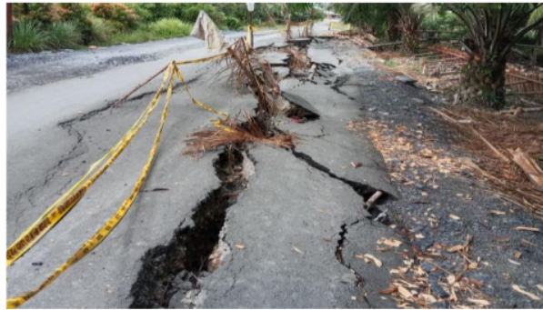
Gambar 2. Dokumentasi kerusakan jalan di Jalan Serindang, Desa Serindang (Dokumentasi pribadi, 2021)
