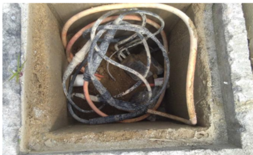
Gambar 5. Bak Kontrol dan Trafo Series
