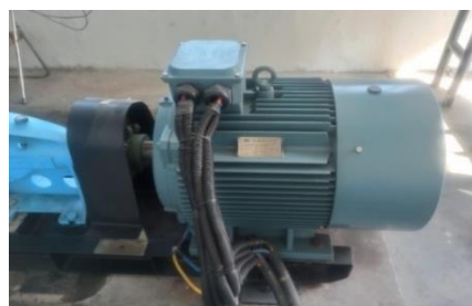
Gambar 3. Motor Penggerak Pompa Sekunder
