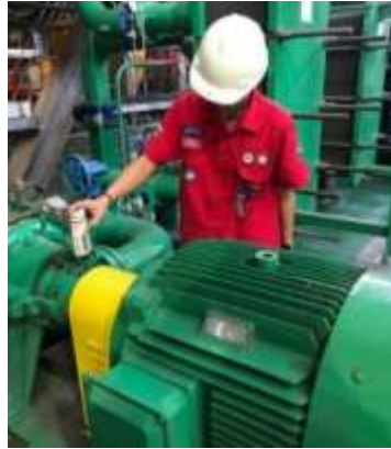
Gambar 5. Pengecekan vibrasi pada bearing CCWP
