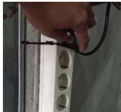
Gambar 3. Menyalakan sistem heating control
